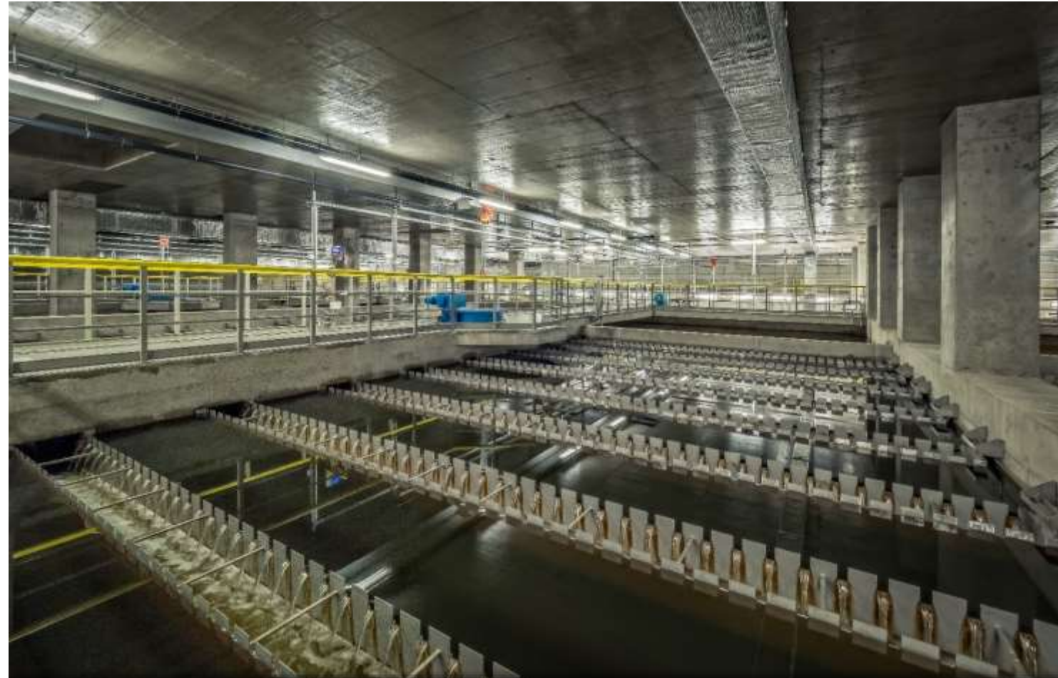
Terciární čištění – lamelové separátory Densadeg 2D – pohled na odtok vyčištěnou vody přes nerezové žlaby.
