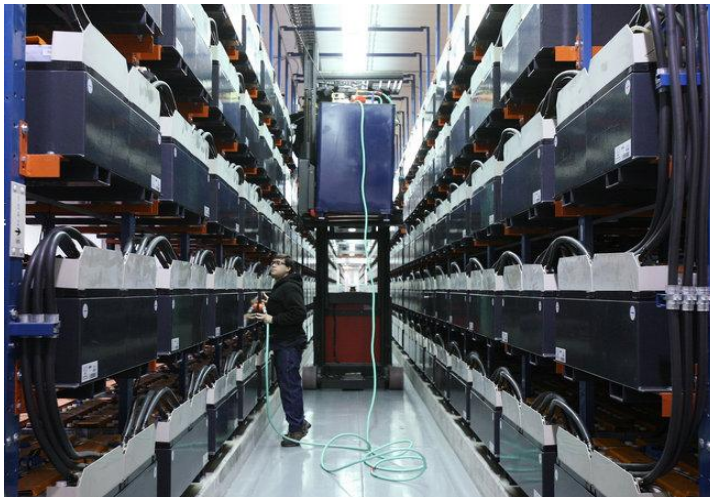
BESS (Battery Energy Storage System), GVEA Místo: Fairbanks, Aljaška, USA
