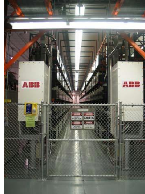
Hala akumulátorů AB Soft
