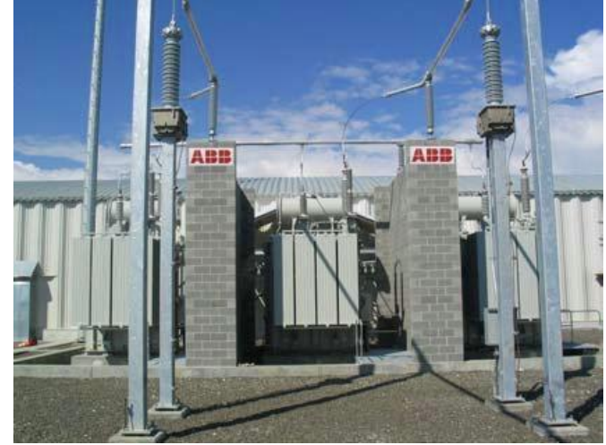
Výstupní transformátory 3x1f
